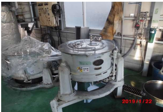
Fig.1 機番②遠心脱水機
